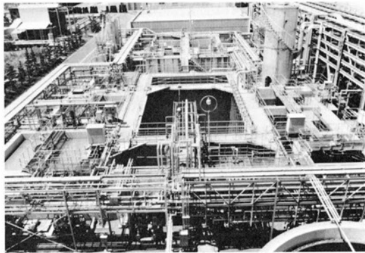
仙台火力(発)排水処理装置
