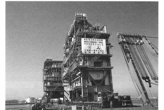
東新潟火力(発)第4-1号系列HRSG据付工事 ボイラモジュール運搬
