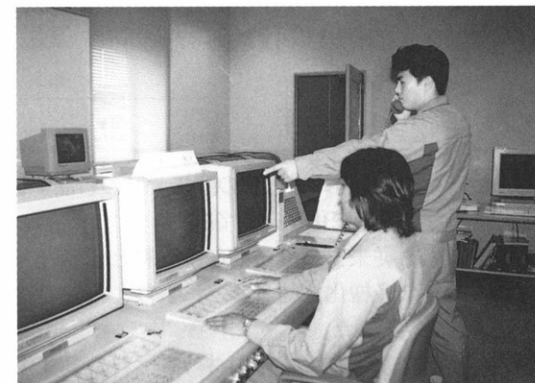
CRT制御方式による環境装置運転業務(原町火力(発)環境装置集中管理室)
