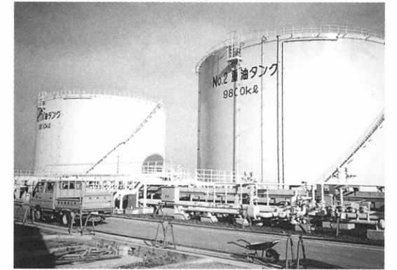
東北電力原町火力発電所重油タンク
