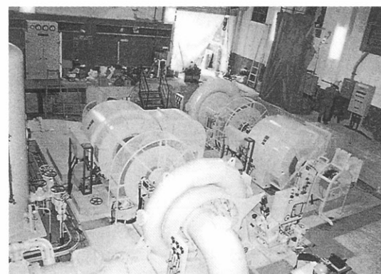
鶴沼川発電所リプレース後
