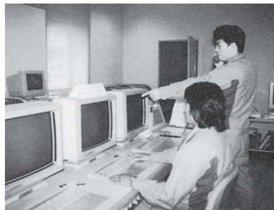
CRT制御方式による環境装置運転業務 (原町火力(発)環境装置集中管理室)
