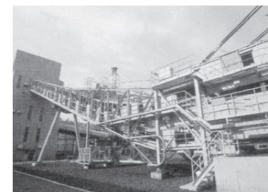
能代火力発電所 No.9Eベルトコンベア急傾斜部
