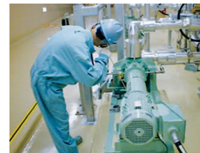
ポンプ運転音確認(女川原子力(発))
