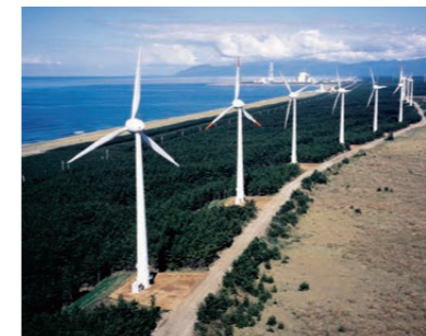
東北自然エネルギー開発(株)能代風力発電所
