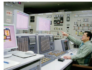
相川火力(発)運転業務状況
