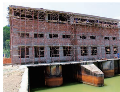
ソンマック発電所全景 放水路側
