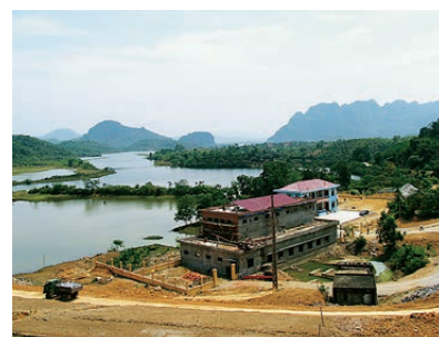
ソンマック発電所全景
